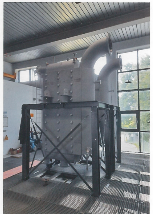
Bild 2. Die neuen Heizkondensatoren passen exakt in das Gestell der alten hinein. Deutlich zu sehen sind die 90°-Rohrbogen (rechts oben) und die neu designten Heißwassereintritte (links oben)
