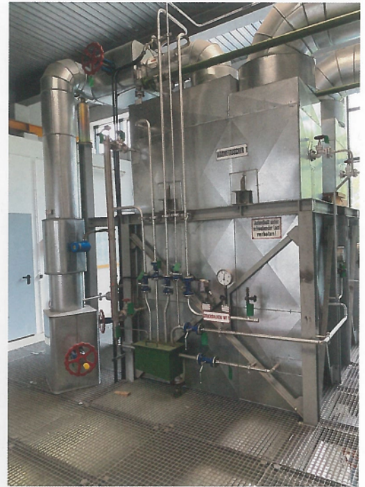
Bild 1. Altbestand: Heizkondensatoren mit 2 x 18 MW
